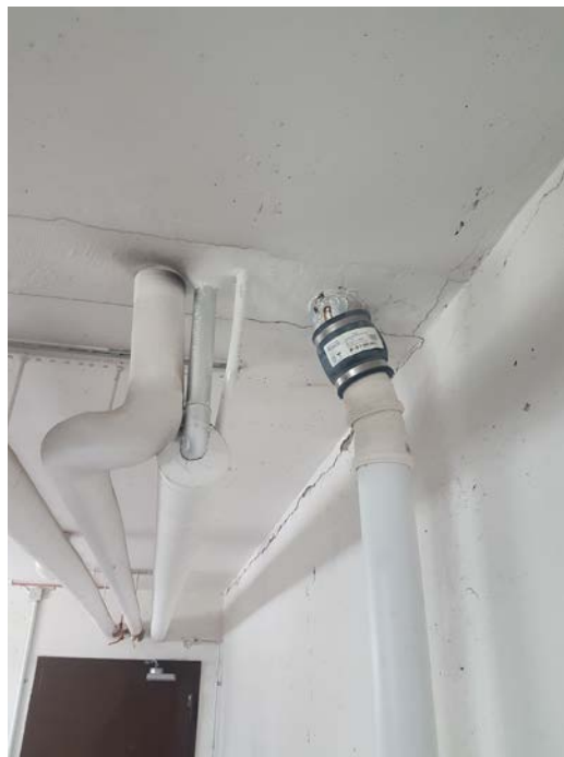
Dåliga avloppsstammar, lagade
