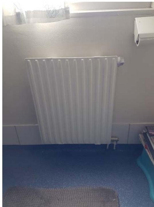
Radiator med ettrörsystem, dolda ledningar i golv
