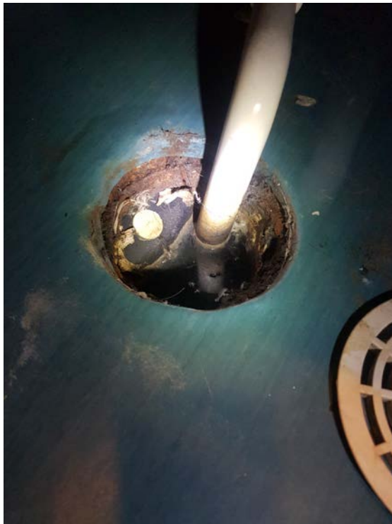
Golvbrunn med förhöjningsring, läckage
