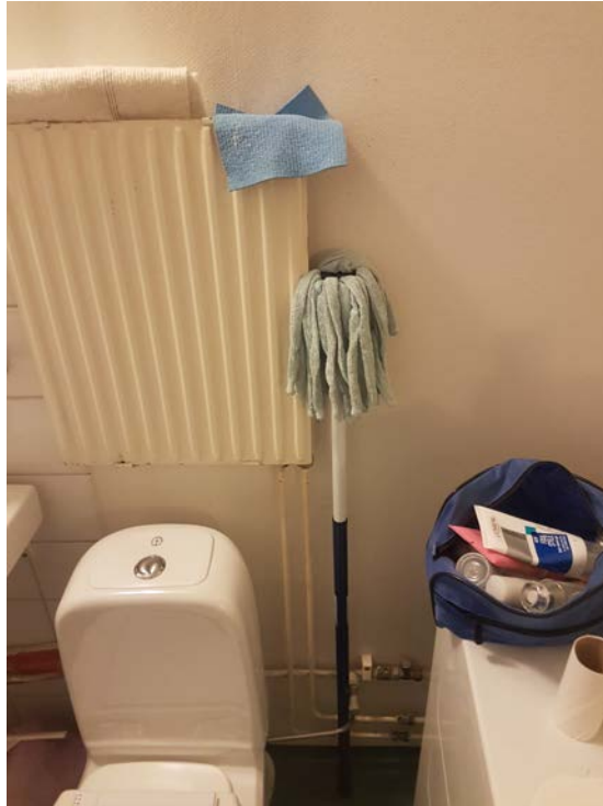
Radiator i badrum med dold värmestam, läckage i flera badrum
