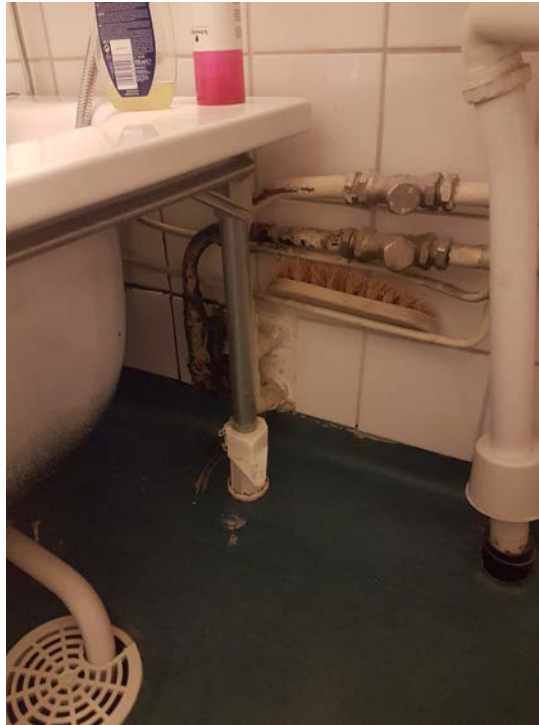
Osäkra avstängningsventiler i badrum
