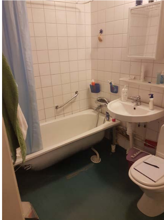
Badrum i originalskick, dåliga ytskikt
